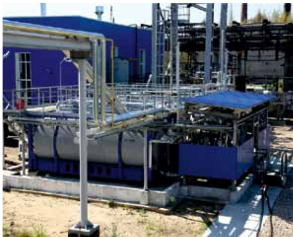
Склад сырья участка «Добавки в цемент InCEM»
